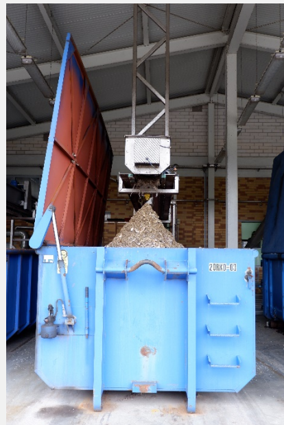
Container mit Rechengut
