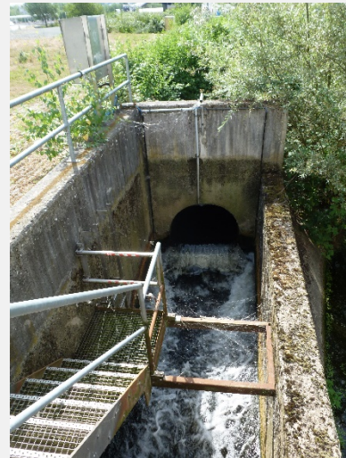
...aus dem Klärwerk...
